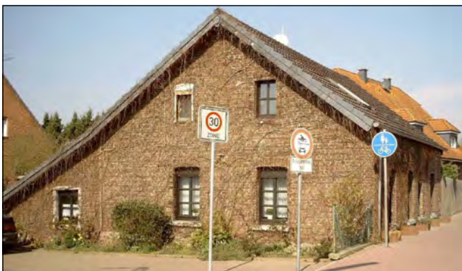
Gebäude an der Genroher Straße, Ecke Am Flitz. Leider ist die Straße immer stärker angewachsen, so dass das Haus in der Erde versinkt. Das rosa Betonsteinpflaster des Gehwegs beißt sich mit dem braunroten Backstein. Die braunen Sprossenfenster lassen das Gebäude zu finster erscheinen. Der Wilde Wein gibt dem Haus zu jeder Jahreszeit einen anderen Charakter. Leider irritiert der Schilderwald vor diesem Haus.
