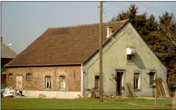
In unmittelbarer Nähe steht das Wohn-/Stallhaus dieses Hofes leer. Die verputzte Giebelwand ist ein Zeichen des Wohlstandes gewesen, die den Wohntrakt deutlich vom Wirtschaftsteil abhebt. Auch wenn eine Sanierung nicht zeitnah angestrebt ist, sollte der Bestand vor dem weiteren Verfall gesichert werden.
